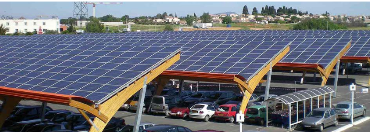
Ombrières photovoltaïques | Vue aérienne - Structure type bois
