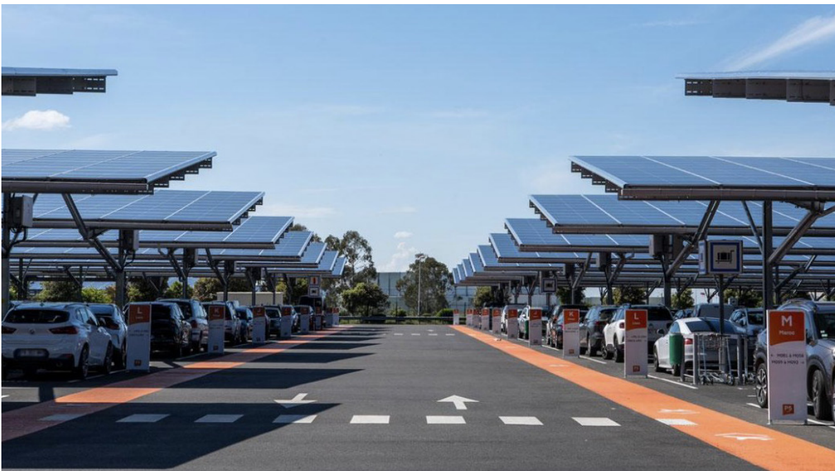
Ombrières photovoltaïques | Vue depuis allée parking
