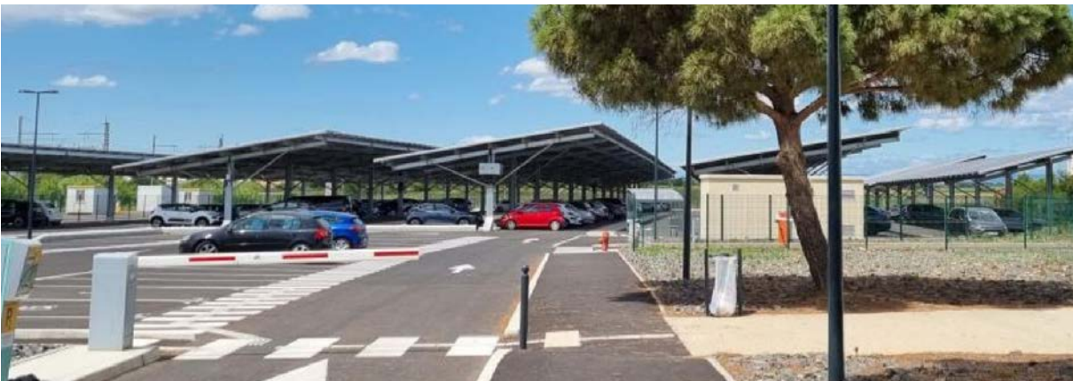
Ombrières photovoltaïques | Vue entrée parking
